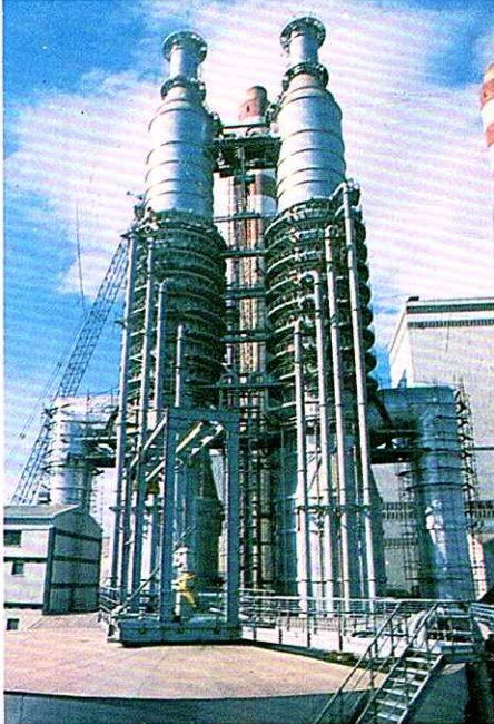
2 x 150 MW Çayırhan Termik Santrali Baca Gazı Kükürt Arıtma Tesisi Anahtar Teslimi Yapımı
